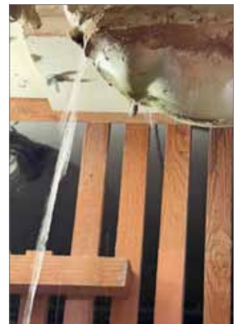
Dieser Wasserstrahl aus dem Rohr war erst der Anfang. Foto: zg
