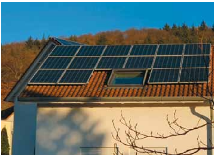
Westseite des Hausdaches mit 16 Solarmodulen Foto: Beate Steinel
